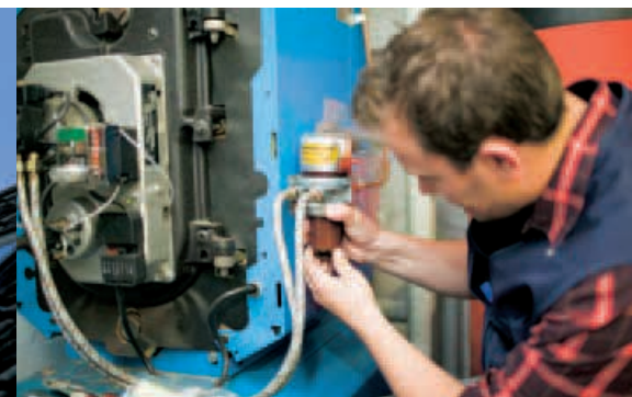
Verstopfte Ölfilter, verschlammte Öltanks und defekte Heizkessel verursachen Kosten und den Ausfall der Heizung.
